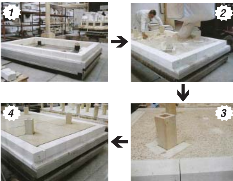
รูปที่ 5-8 : แสดงขั้นตอนและวิธีการติดตั้ง Ultralite ลงในรถเตา
